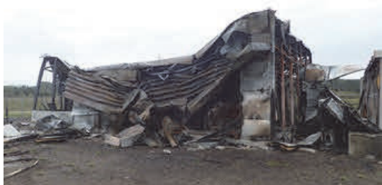
【火災後の蓄電池設備建屋】
